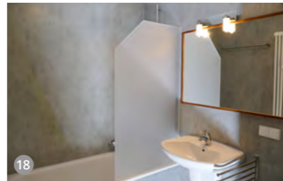
18 Fertig Nach wenigen Stunden ist das Silikon bereits angehärtet und kann Feuchtigkeit standhalten. Mit der intensiven Nutzung sollte man warten, bis das Silikon nach einigen Tagen abgebunden hat.
