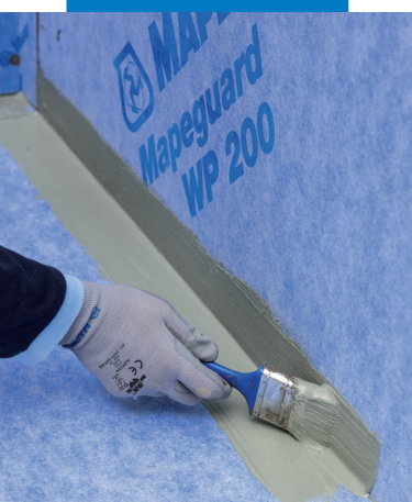
Auftragen des Klebstoffs Mapeguard WP Adhesive im Wand-Boden-Bereich vor dem Aufbringen des Dichtbandes Mapeguard ST
